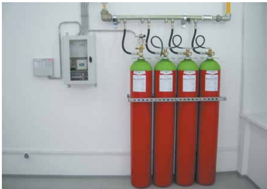
Рис. 25. Внешний вид смонтированной батареи модулей с инергеном
